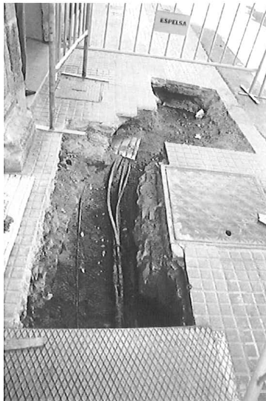
Imatge 3. Ampliació de la cala anterior (imatge 2) on apareix un servei elèctric ja instal·lat anteriorment
