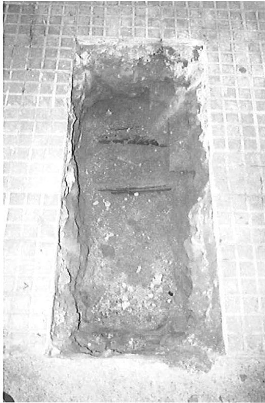
Imatge 2. Vista de la cala oberta abans d'excavar la rasa del carrer Ramelleres
